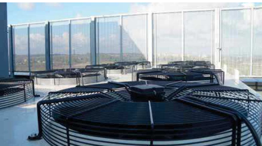
Drycoolery zlokalizowane na dachu
